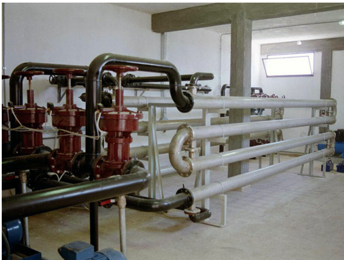
Scambiatori di calore, impianto di depurazione Bari orientale superficie di scambio 30 mq portata 200 mc/h
